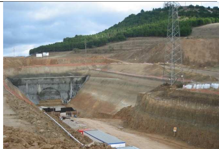
Ejecución de las obras Túnel del Cerro de San Cristóbal excavado en mina
