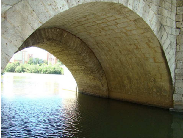
Uno de los ojos del puente en donde se aprecia la duplicación de su anchura por el resalte en el intradós del arco.
