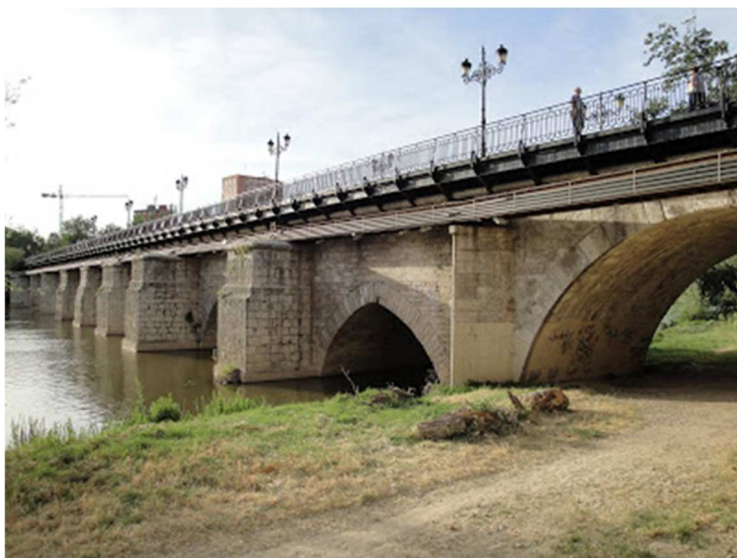
La horizontalidad actual del tablero del Puente Mayor.
